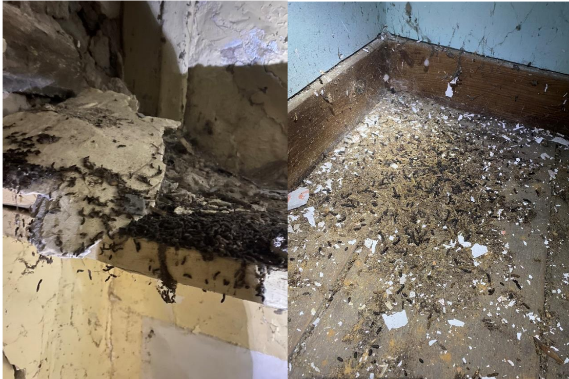
Guano de chauve-souris dans la cuisine (à gauche) et à l'étage (à droite) ©ETEN Environnement
